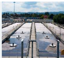
Очистка сточных вод
